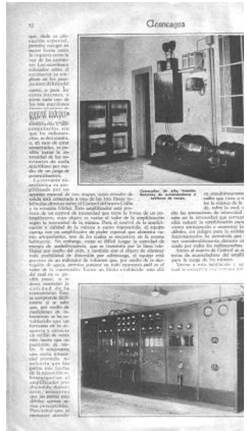
Generador de alta tensión. Baterías de acumuladores y tableros de carga
